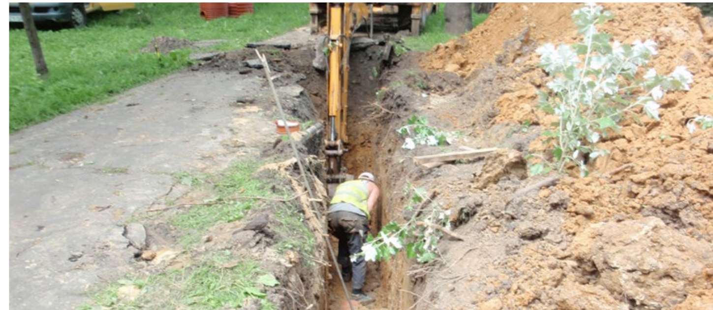
Fot. 20. Wykonywanie prac w Strefie Ochronnej Drzewa (SOD) metodą otwartego wykopu powoduje uszkodzenie korzeni
